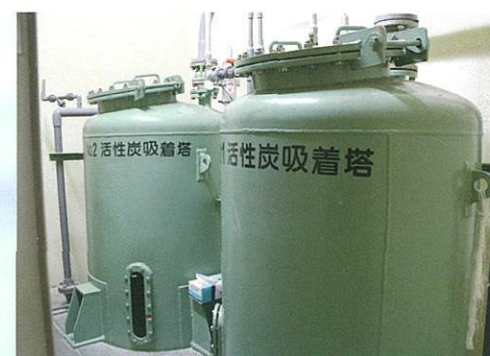
■活性炭吸着塔
