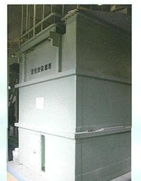
■活性炭吸着塔
