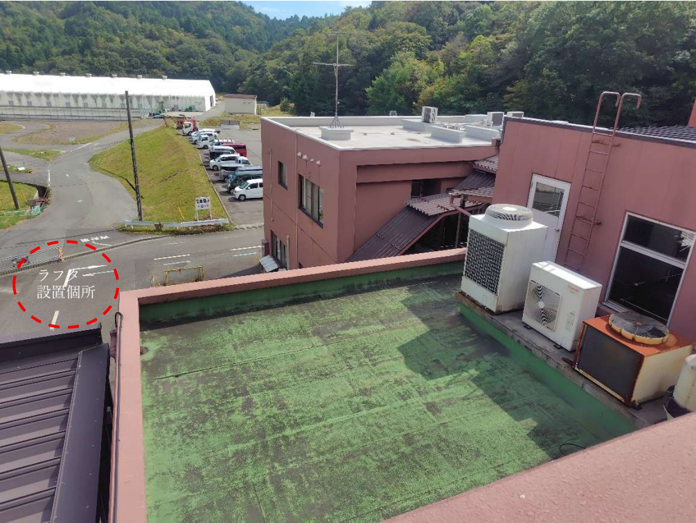
2 階室外機置場
