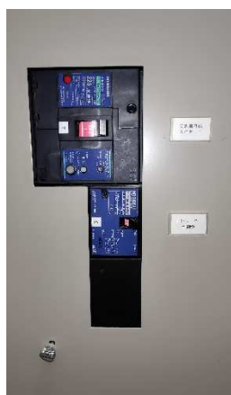
空調室外機用遮断器
