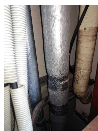
室外機置場シャフト内
