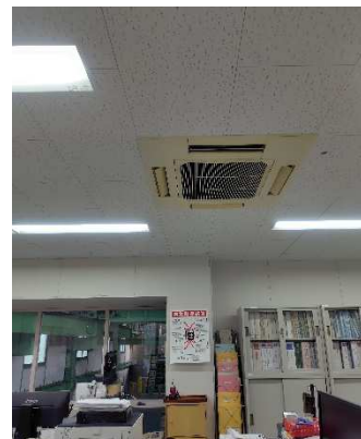
中央監視室・事務室 ACP-1-2
