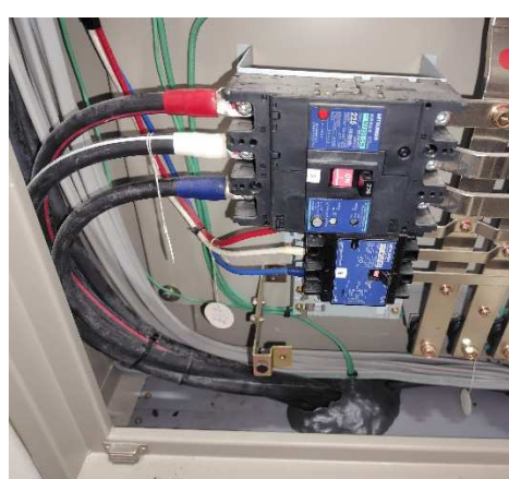
盤内配線状況
